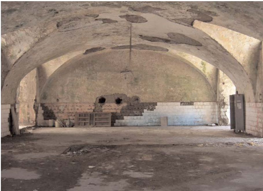
Vue partielle d'un espace voûté sous une des nefs de l'église inachevée, espace proposé pour un centre de communication sur le patrimoine mondial Foto: Nicolas Detry, 2005
