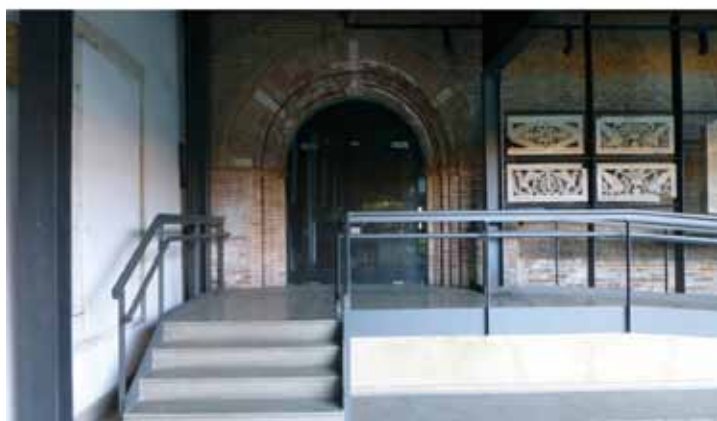
Fig. 9 – Deux images du cloître mineur réalisé en structure métallique selon le projet de Franco Albini de 1969-1970 ; l'accroche du cloître avec l'église a été modifiée au début des années 2000. En haut, la façade Sud du cloître ; en bas, détail d'une porte d'accès à l'église © cliché de l'auteur.
